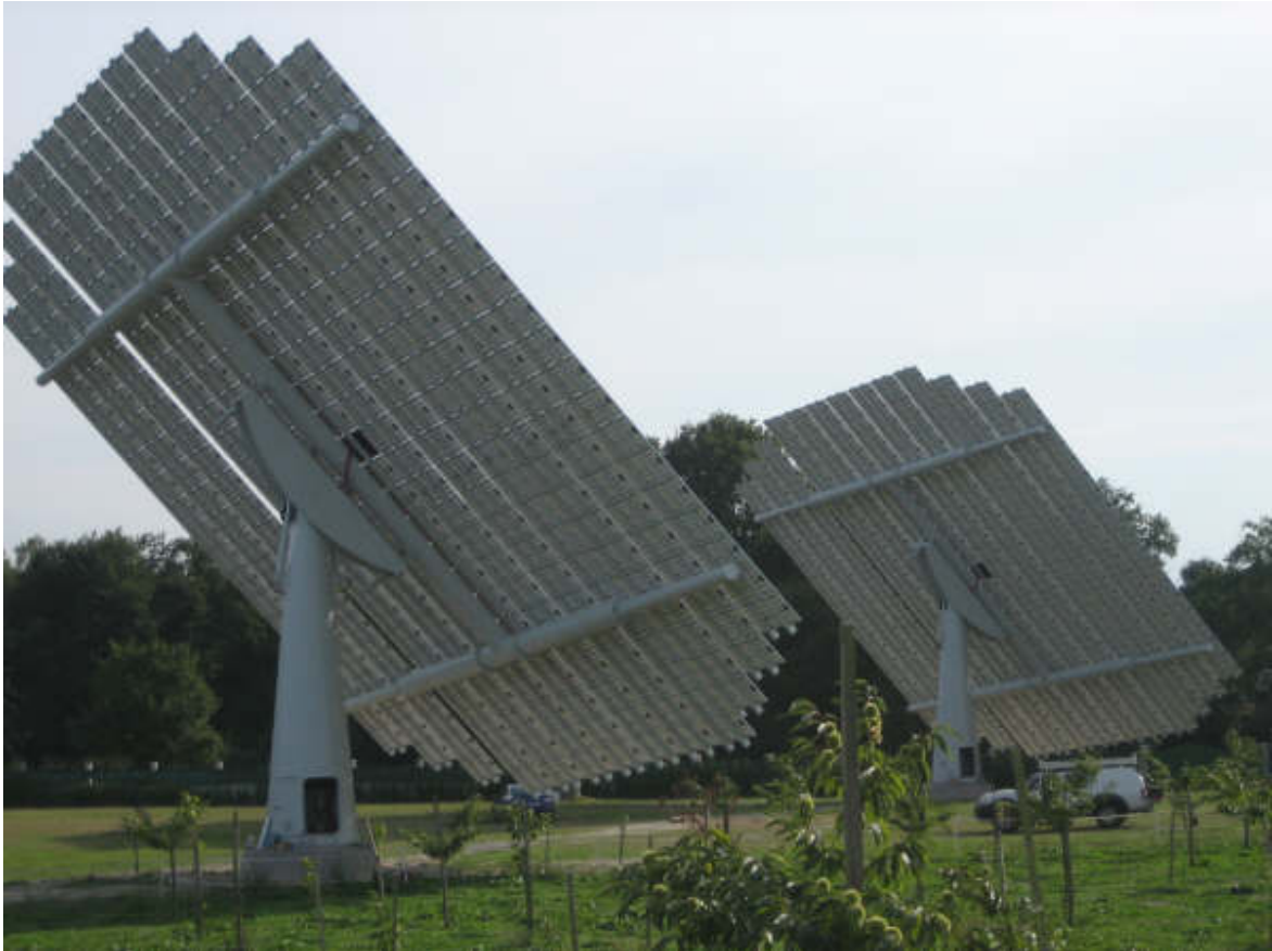
Instalación solar de 108 kWp en Esgos (OURENSE)
