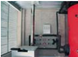
Sala de acumuladores, caldera e impulsión
